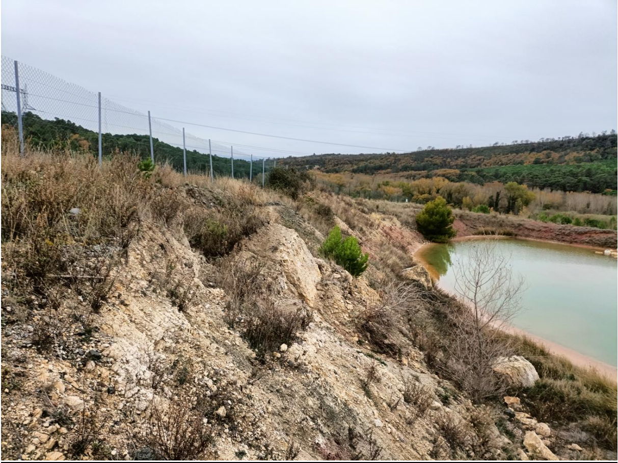
Point d'observation 19 : Instabilité sur talus Sud du bassin1 – légère évolution
