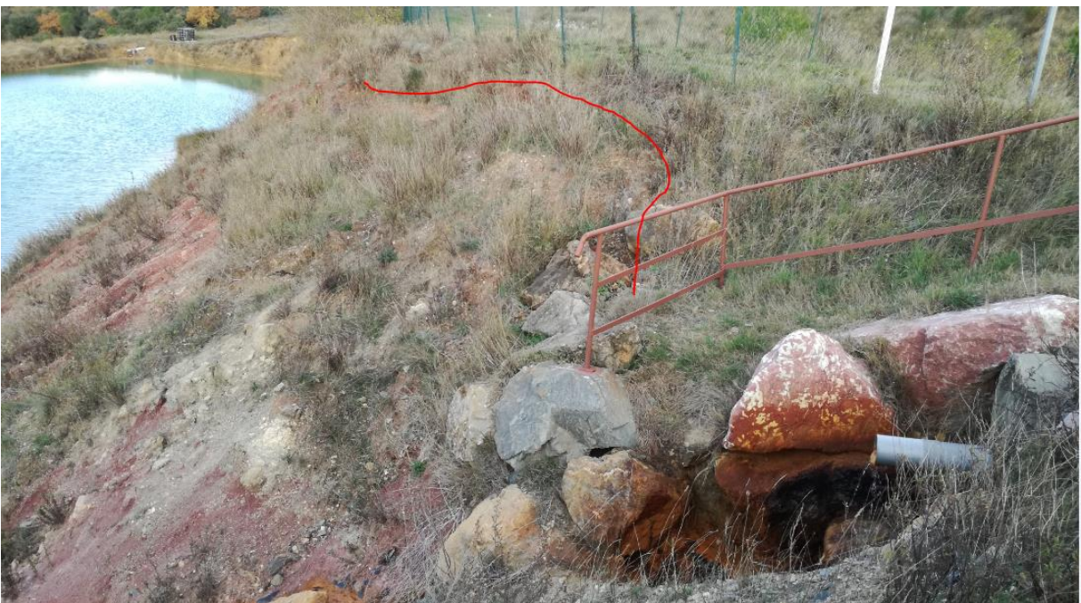
Point d'observation 18 : Instabilité sur talus Est du bassin1 (2020)
