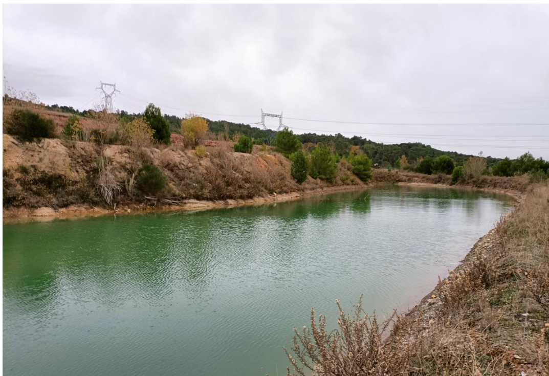
Point d'observation 8b situé Entre le bassin 2 et le bassin 3 : ravines sur talus à surveiller
