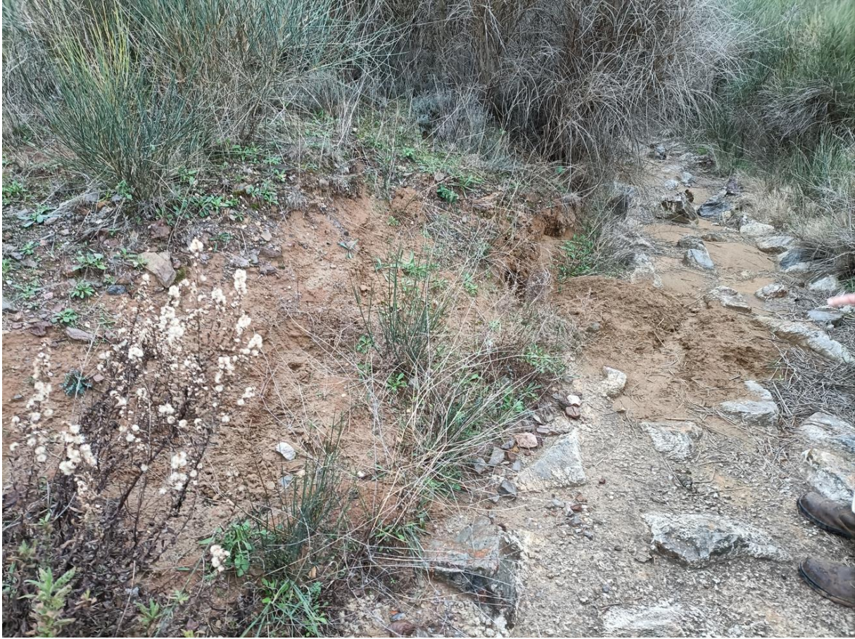
Point d'observation 33 : Mise à nu des résidus miniers devant enrochement (partie haute de la rampe)
