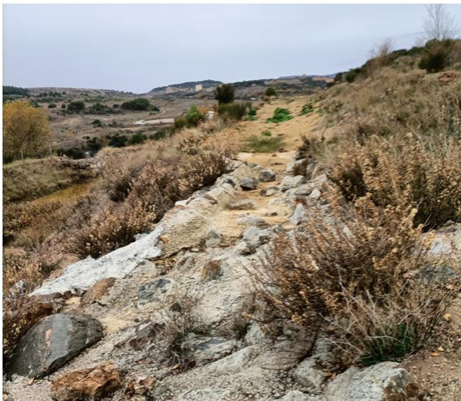
Point d'observation 6a : zone où le fil d'eau du fossé doit être reprofilé
